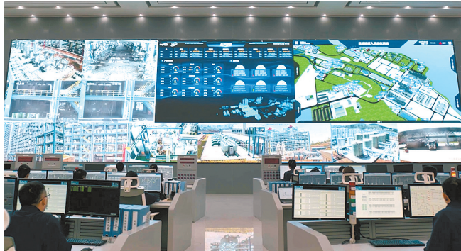
云能硅材DCS控制室。
