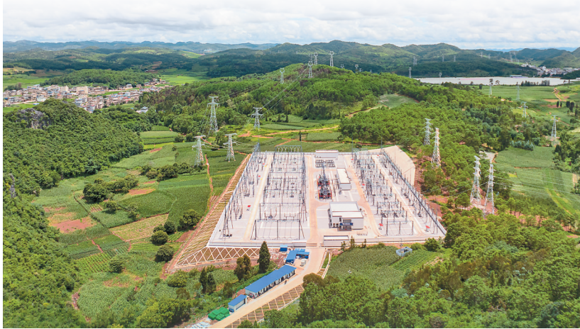
220千伏碧云变输变电工程。 文山供电局供图
