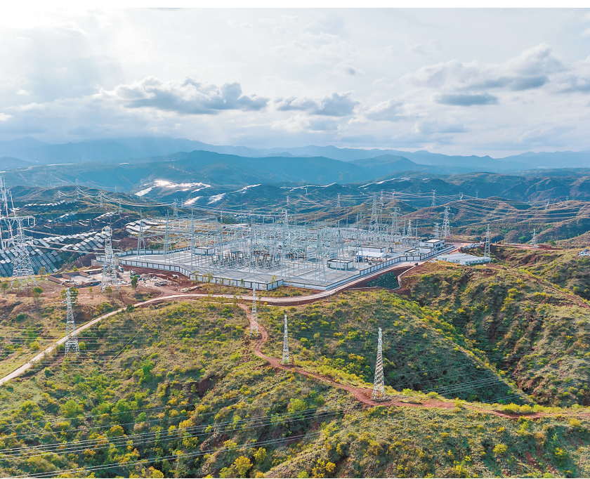
位于永仁县的云南规模最大“源网荷储”一体化新能源集群项目。
