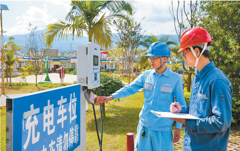
工作人员对充电桩进行检查。
