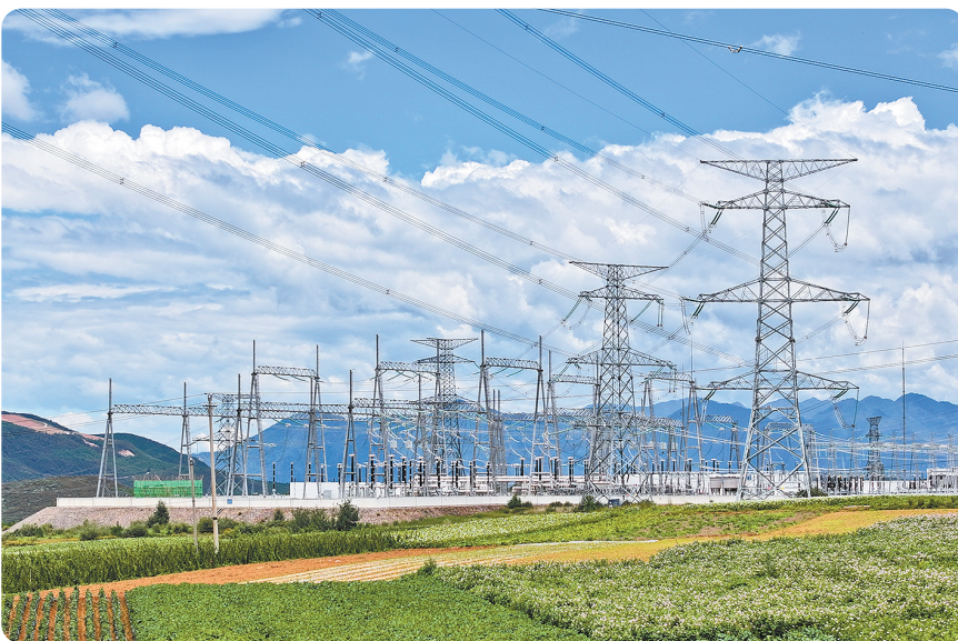
丽江供电局500千伏太安变电站侧景。
