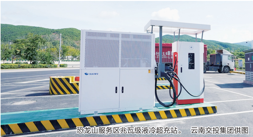
恐龙山服务区兆瓦级液冷超充站。 云南交投集团供图
