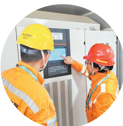
工作人员全力保障2024腾冲科学家论坛主会场供电。 赵凌 摄
