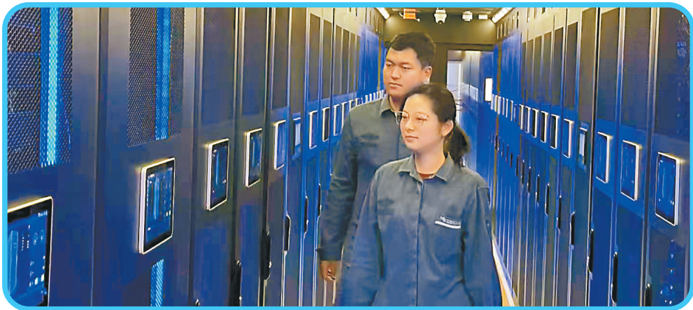
工作人员常态化开展机房数据中心维护和服务器设备检测。
