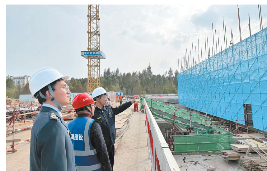
昆明市生态环境局滇池度假分局巡查昊滇建设集团项目工地。 本报记者 王琼梅 摄
