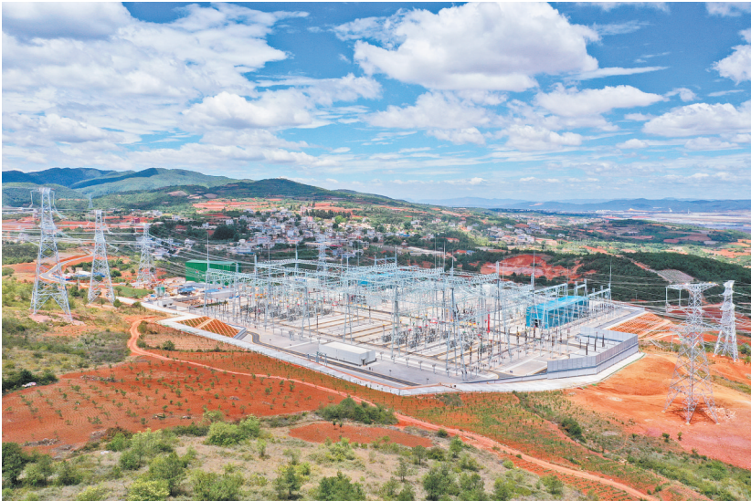
500千伏白邑变电站全景
