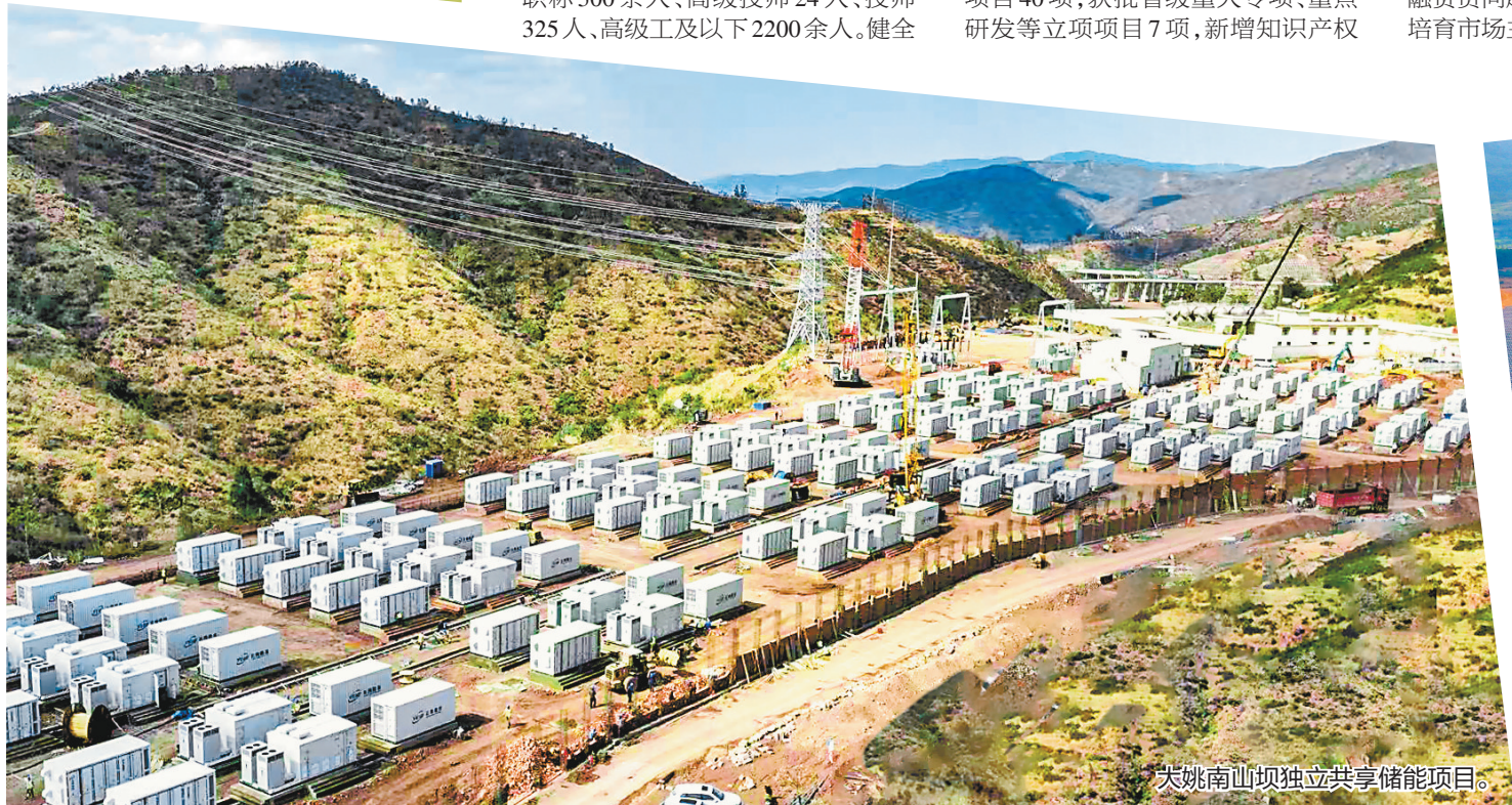
关姚南山坝独立共享储能项目。
