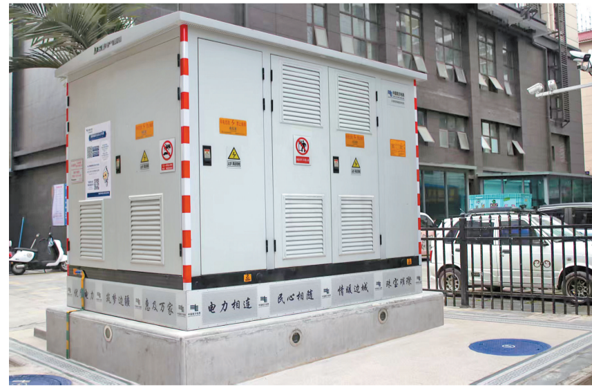
改造后的变压器 邵方冰 摄
