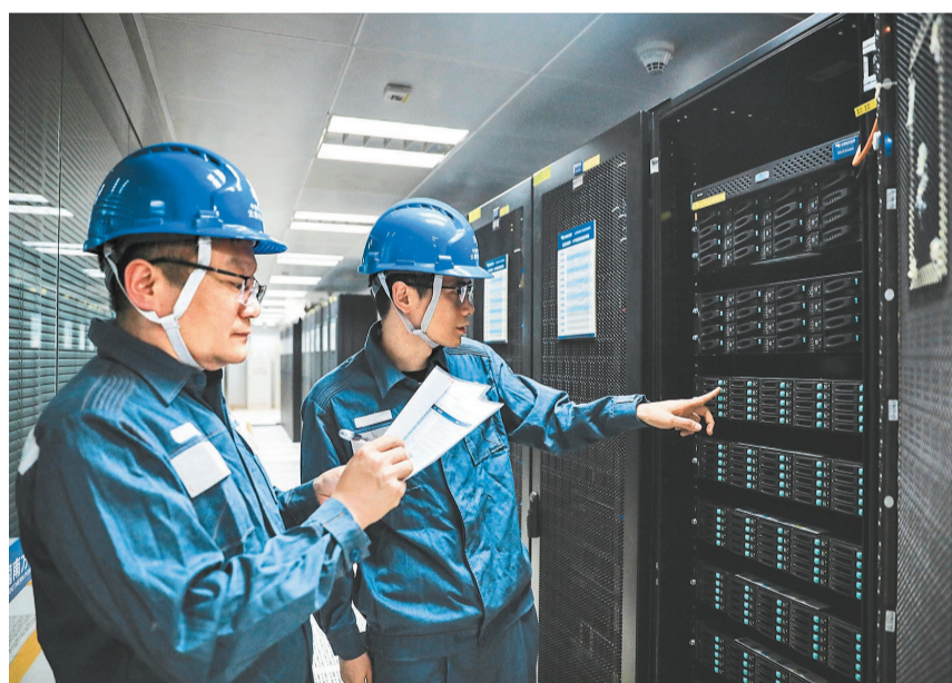
工作人员对通讯机房开展日常巡视。肖庭波 摄
