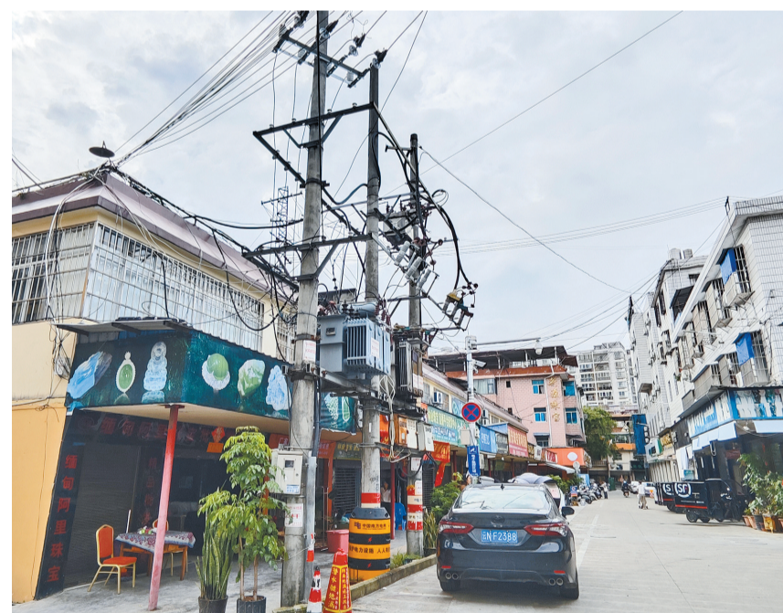
改造前的变压器 雷锦涛 摄
