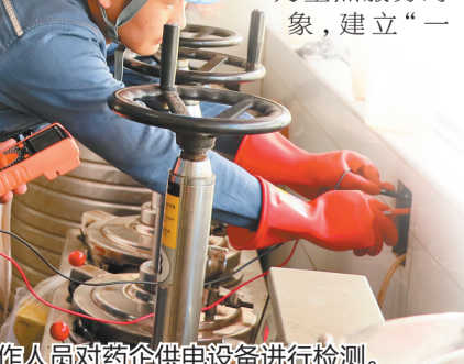
电力工作人员对药企供电设备进行检测。吴楠 苟岚岚 文图
